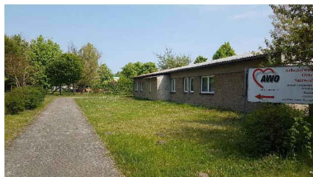
Abbildung 107: Unsanieretes Sozialgebäude südlich der Kindertagesstätte "Max und Moritz" 114
